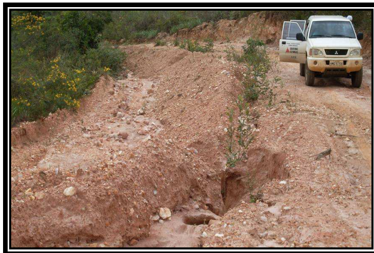
Figura 03 - Erosão em sulcos em estrada de acesso ao Rio Almesca. Fonte: SOARES, Rita Adriana de C. Martins (2010).
