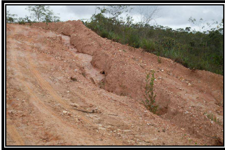
Figura 02 - Estrada de terra com grande processo erosivo. Fonte: SOARES, Rita Adriana de C. Martins (2010).
